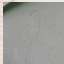
Tag sur un mur
